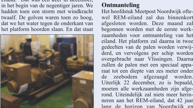
De stroomvoorziening op het eiland is door middel van drie krachtige genera-toren.
