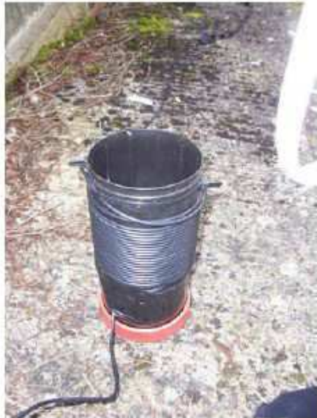
Bobine de choc HF utilisée par G7FEK dans son câble d'alimentation
