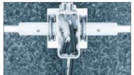
Bild 4: Blick in die Anschlußdose mit den angeschlossenen Anpaßleitungen
