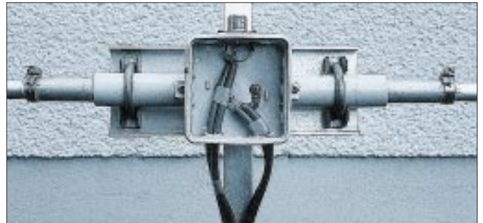
Bild 13: Aufbau des Strahlerelementes und Blick in die Anpaßdose
