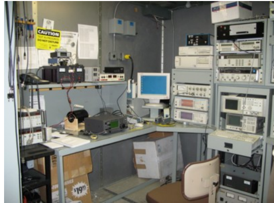
มีระบบ RF-Shield-Room เพื่อทดสอบและพัฒนาเทคโนโลยีด้าน RF พร้อมเครื่องมือต่างอย่างสมบูรณ์แบบ
