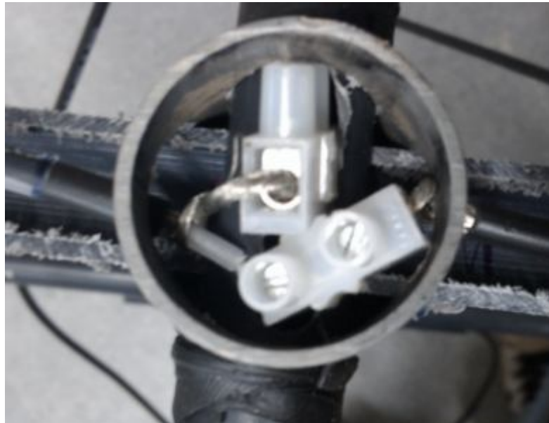
Figura 4.3-6 Empalmes usando borneras, en la parte superior de la antena.
